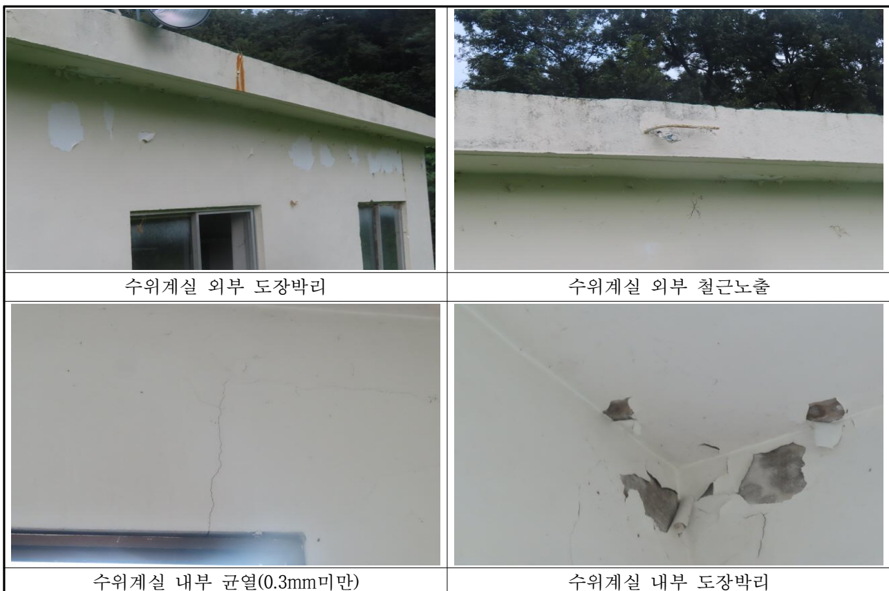
【사진 3.5】 건축구조물 손상사진
