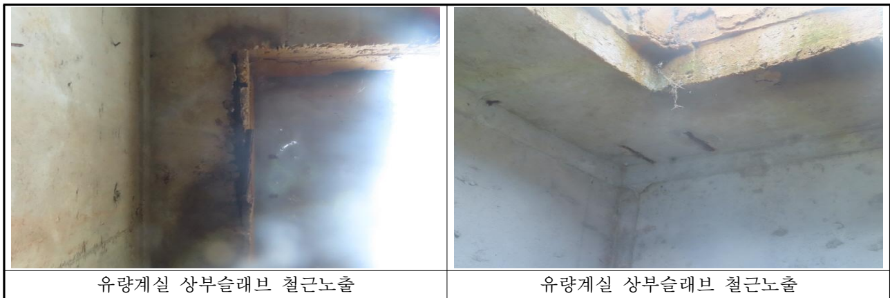
【사진 3.4】 유입·유출 밸브실, 유량계실 손상사진
