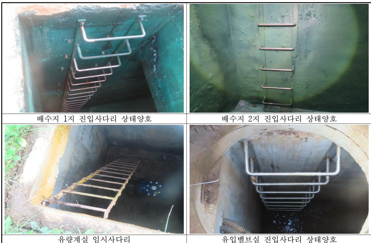
【사진 3.7】 안전시설(점검로) 손상사진
